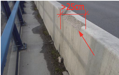
Großflächige Abplatzungen - Durchmesser >25cm
