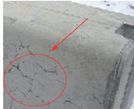
Nicht-strukturelle Risse - netzartiges Rissbild
