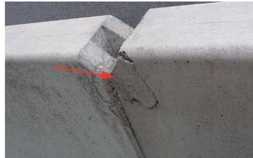
Starke Abplatzungen am Y-Profil
